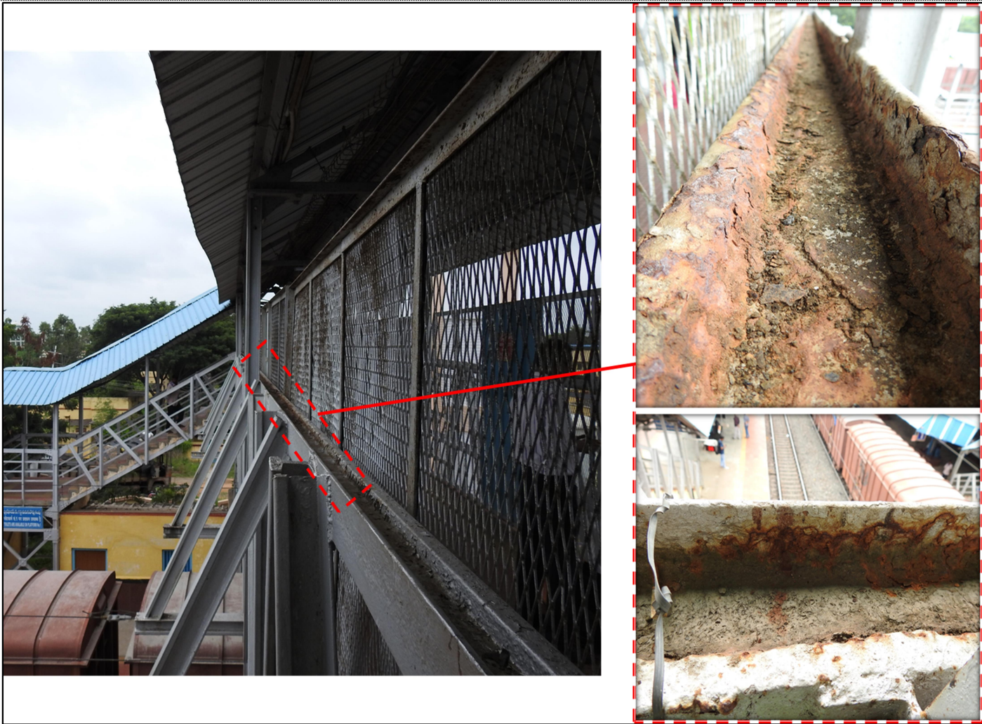
(d) Rusting and corrosion at top chord
